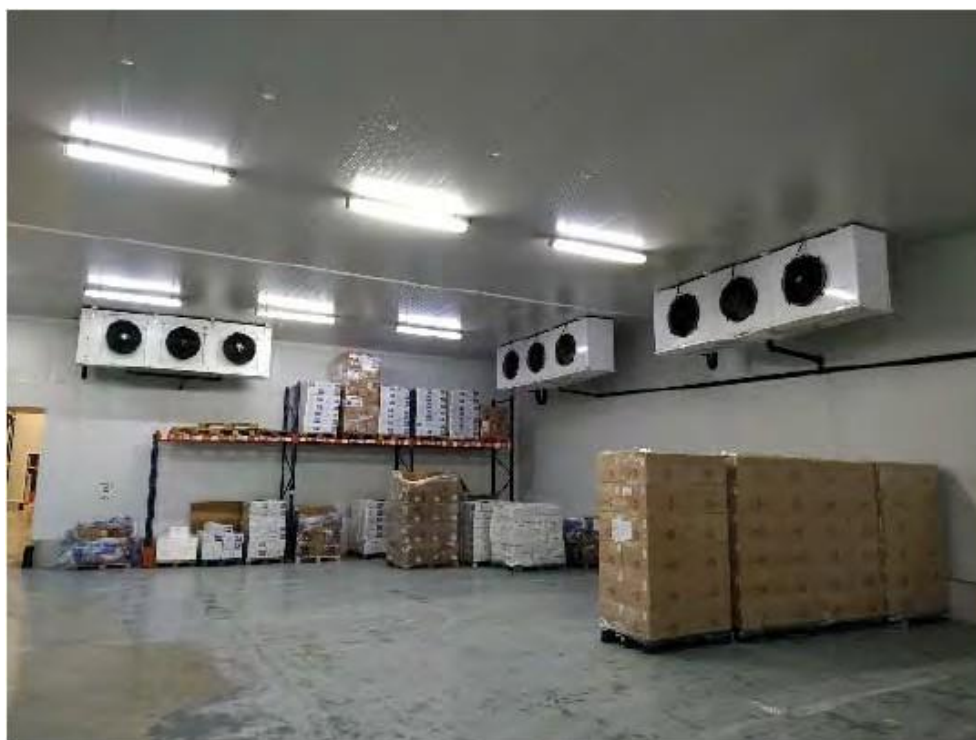
Figura 8: Central de compresión de baja temperatura
